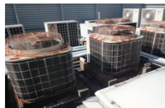
さび・劣化が激しい
