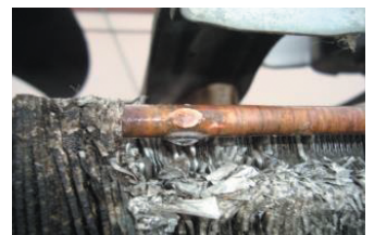
配管に穴が空いている
