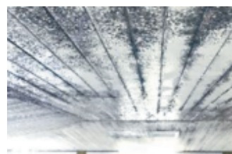
天井にカビが発生している
