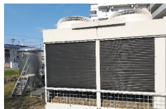
フロン点検できていない
