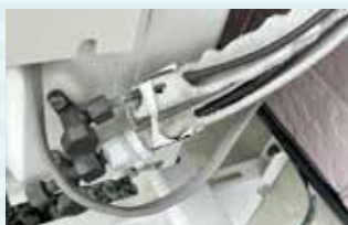
配管が剥き出しになっている
