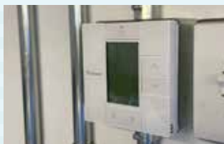
エアコンが動かない
