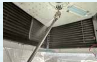
熱交換器を洗浄していない
