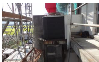
室外機から異音がする
