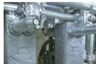
熱交換器が 結露する...
