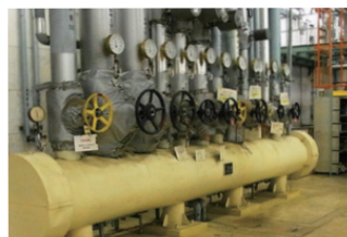
蒸気配管がむき出で 結露する...
