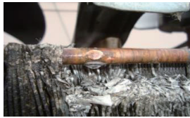
冷媒漏れの防止
