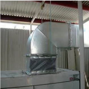
排気ダクトに断熱ができていない...
