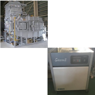
工場内にコンプレッサを設置している...
