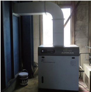
排気ダクトが接続されていなくて、熱がこもる...
