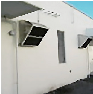
コンプレッサ室がなく、温度管理ができない...
