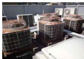
冷媒配管にピンホールが 発生している...
