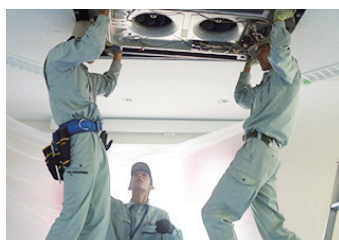
冷媒配管の 距離が極端に長すぎる...
