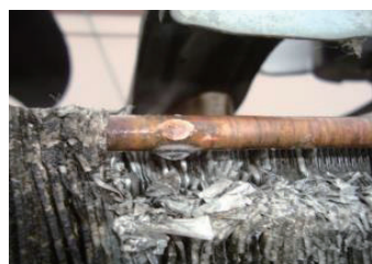
冷媒配管がむき出しな 箇所がある...
