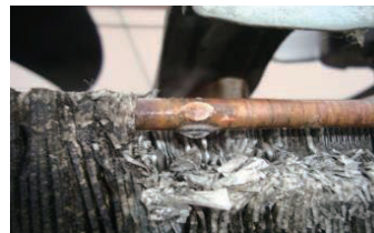
冷媒配管がむき出しになっている…
